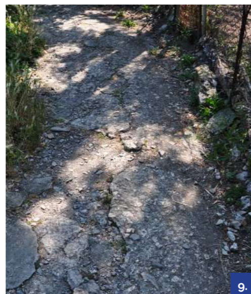
9. Erosione, fessurazione, distacco e mancanze di porzioni di pavimentazione in calcestruzzo in malta di calce. EL_7
