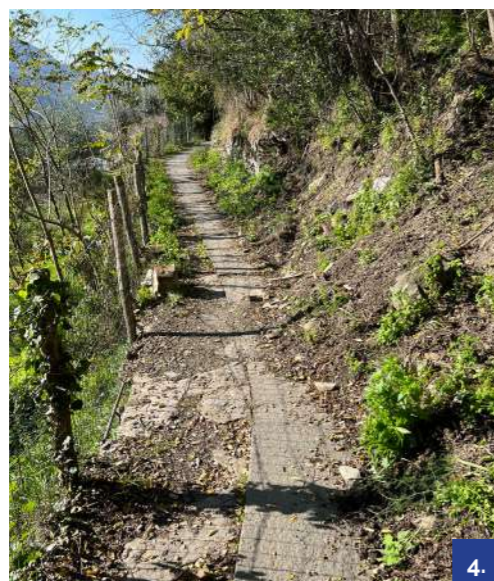
4. Presenza di terra, foglie e altri residui vegetali sul tracciato. EL_6
